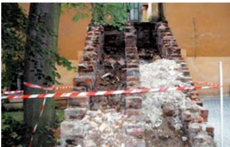
...to staré bylo v havarijním stavu a chození po něm hrozilo úrazem.
