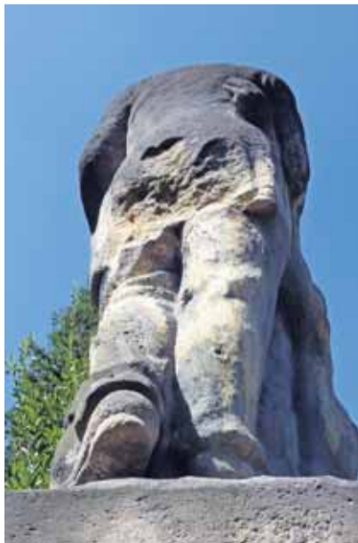
Stav před rekonstrukcí byl žalostný.
