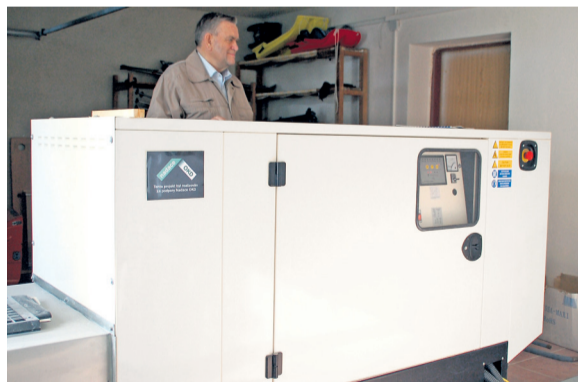
Vladislav Lipus u generátoru k záložní výrobě elektrické energie.
